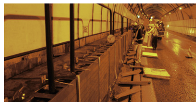
支保工、モルタル充填班作業状況 パネル取付班はこの奥で作業中
