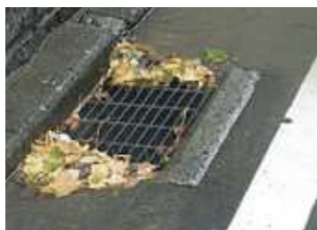
落葉による集水の阻害
