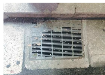
小石による目詰まり
