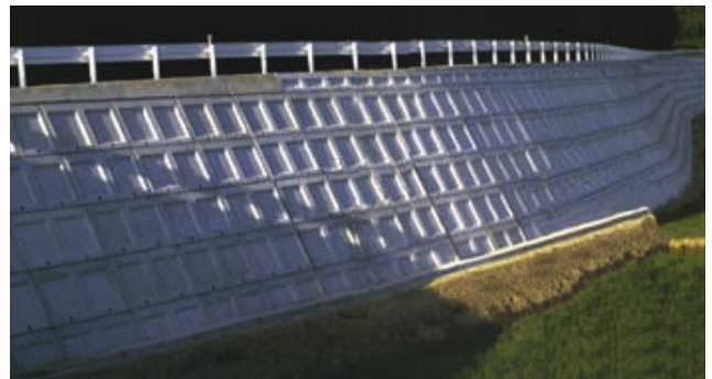
天端に構造物を付けた使用例 [ガードレールを設置した場合]
