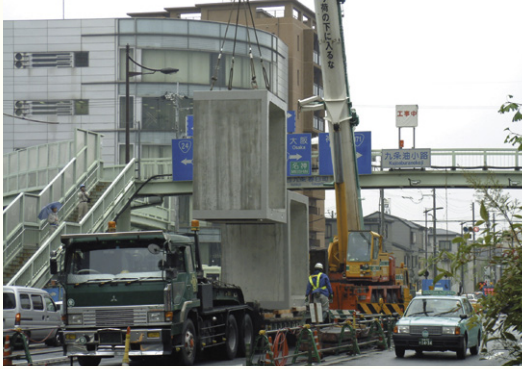
製品寸法：B×H×L=2.55×2.90×2.00m 施工時期：平成14年度 施工場所：京都市南区九条
